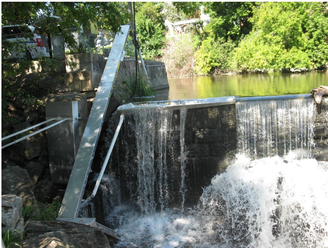
Passe migratoire à anguille installée sur la rivière l'Achigan à St-Lin dans la région de Lanaudière. (Source Chantal Côté, MFFP, 2017).
